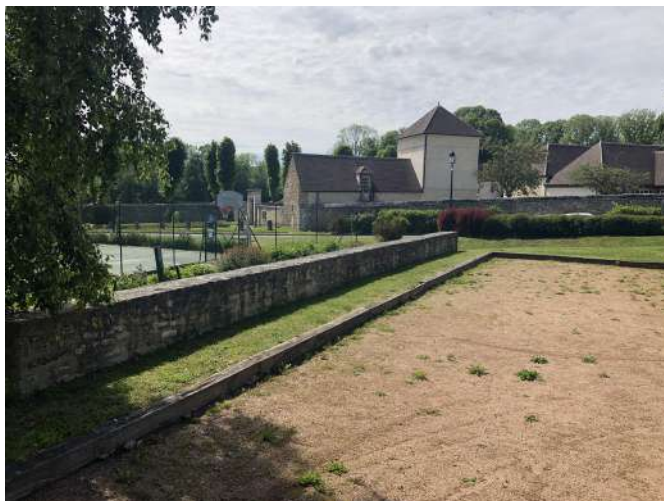
Le muret de soutènement joue également le rôle de banquette informelle pour l'aire de pétanque (Maudétour-en-Vexin).
