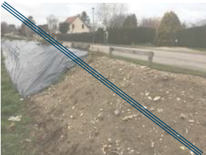
Une fausse bonne idée, où la bâche plastique asphyxie le sol et accélère le ravinement.
